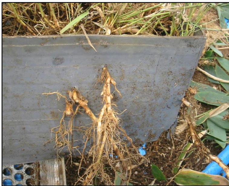
植物の根が防水材を突き破る様子
