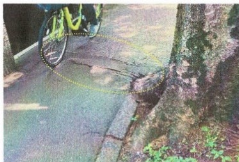
根上り発生状況 (国土交通省 街路樹管理マニュアルより)
