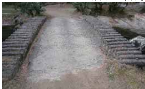
温山荘庭園 擬木土橋
