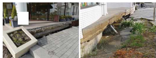
写真5 激しい沈下段差 写真6 沈下による段差と配管破損
