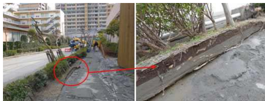
写真9 傾いた街路樹 写真10 刃物で切ったような露出断面
