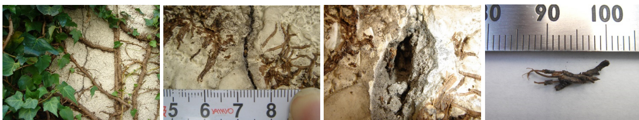
写真5 付着したヘデラ類 写真6 ひび割れに侵入した気根
