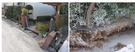
写真3 壊れた門扉 写真4 沈下し露出した生地の根
