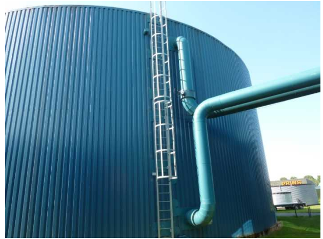
図7 CHP システムと組合せ使用する温湯タンク
