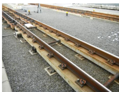
写真3 ラダーまくら木による軌道 （フローティング型）
