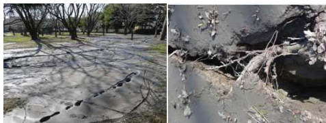
写真1 公園の液状化の連続噴出口 写真2 竜巻により露出したサクラの根
